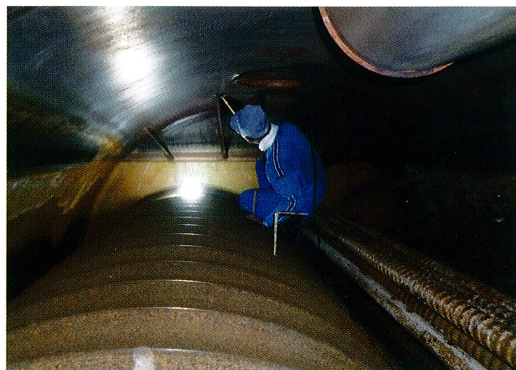
ボイラーの性能検査状況
